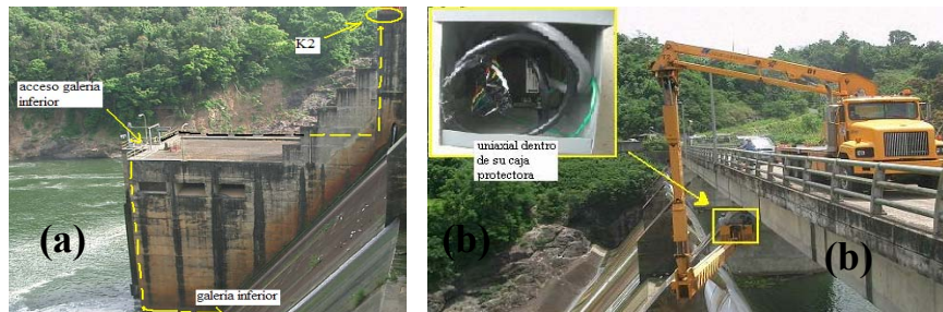
Figura 16: Proceso de Instalación Física de los Acelerómetros en La Represa La Plata: (a) trazado del cableado del K2 al triaxial colocado en la galería inferior; (b) Utilización del snooper para instalación de los instrumentos
